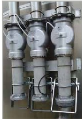
SISTEMA DI SICUREZZA SAFETY SYSTEM
